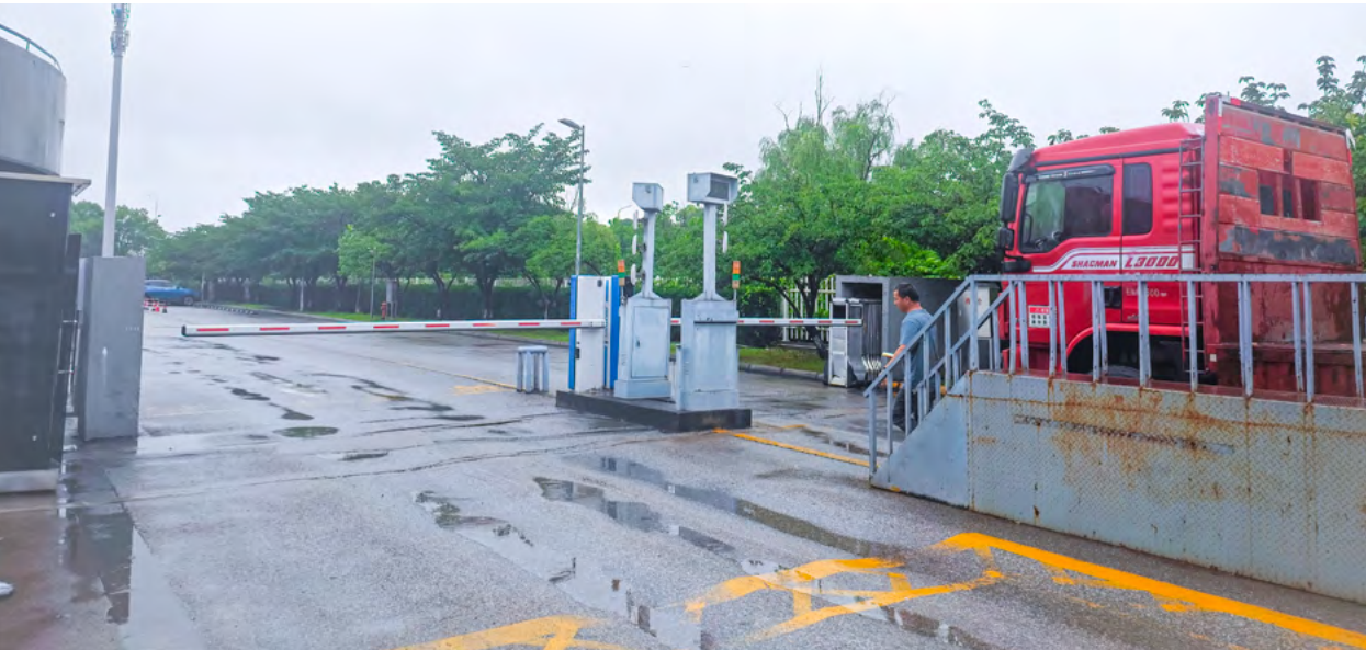
厂区进出门安装车辆识别及自动抬杆系统
